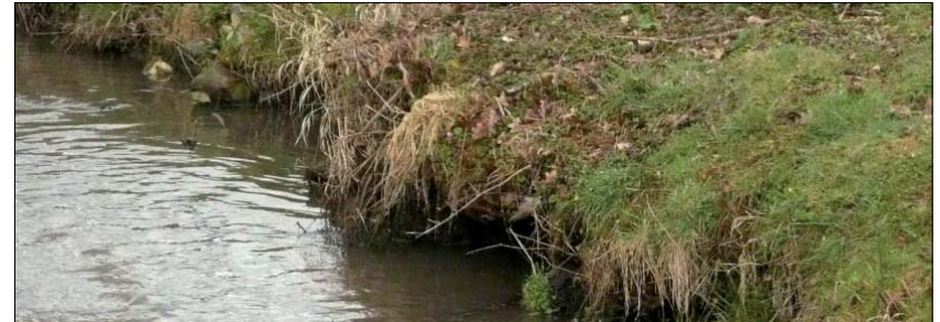
Vieille Thève : berges dégradées
